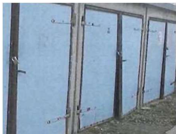
Abbildung 4: Verwahrstelle Garagenkomplex mit schlecht schließenden Toren und Sicherung durch Vorhängeschlösser
