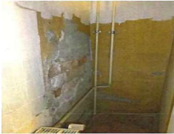
Abbildung 7: Schäden an den Wänden und Decken
